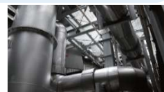
プラント配管
